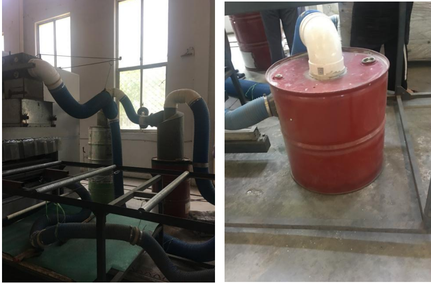
图 4-1 废气治理设施图
